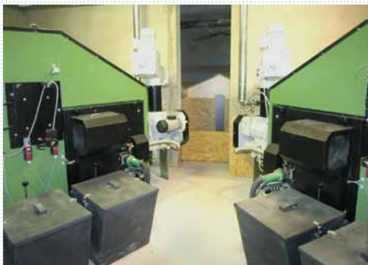
Kościół pod wezwaniem Św. Michała w Lipsku ogrzewany systemem z dwoma kotłami HDG Compact 100.
